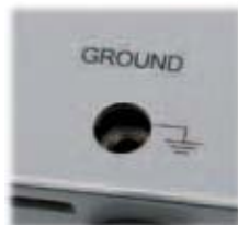
Messa a terra
